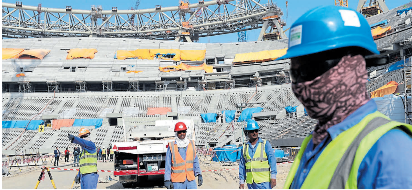
Die Menschenrechtslage von Gastarbeitern war eines der großen Themen vor der Fußball-Weltmeisterschaft 2022 in Katar: Bauarbeiter während der Arbeiten am Lusail-Stadion im Jahr 2019
